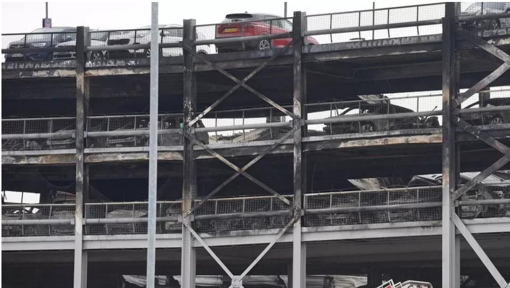
Kuva 26 Tulipalon aiheuttamia vahinkoja.
