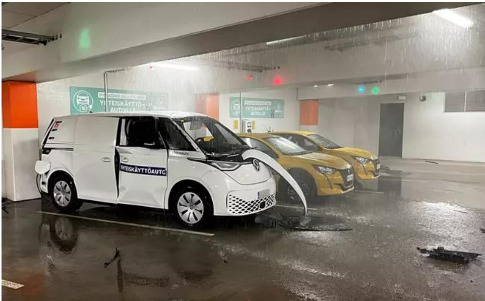
Kuva 11 Parkkihallin automaattinen sammutusjärjestelmä aktivoitui tilanteessa.
