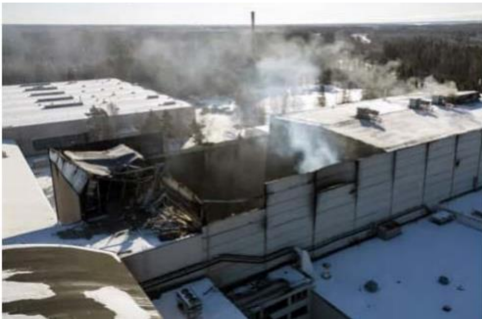
Kuva 10 Rakennuksen katto romahti tulipalon seurauksena.
